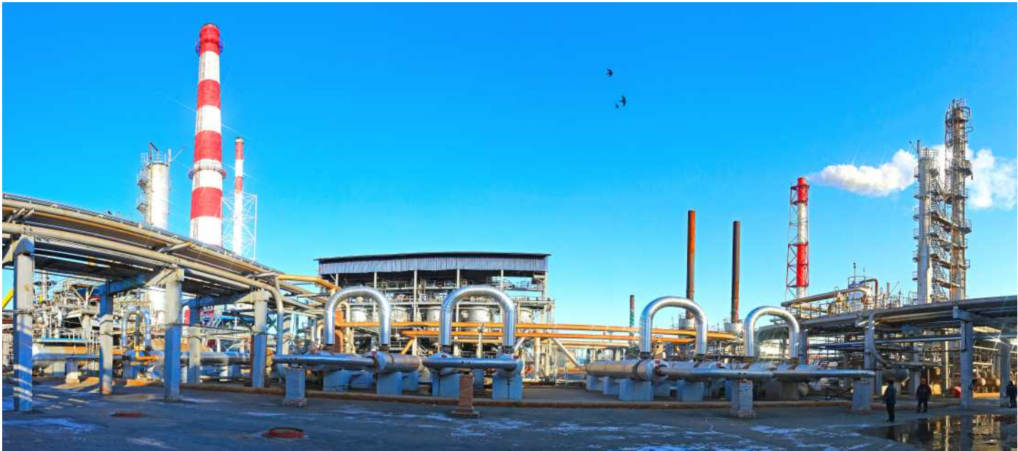
Установка ЛГ-35-11/300-95 цеха №2
