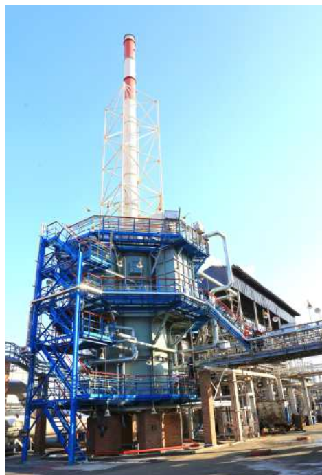
Печь П-1/1 установки ЛГ-35-11/300-95
