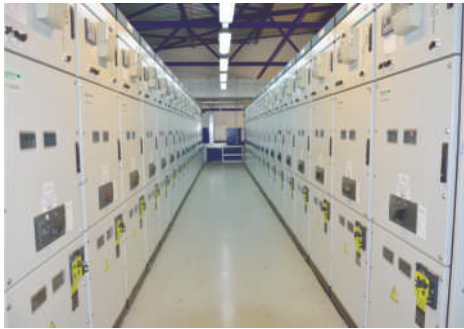
Внутреннее устройство ЦРП-1А
