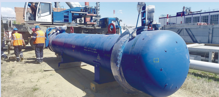
Теплообменник для установки гидрокрекинга
