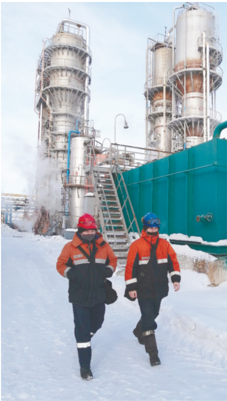
Установка по производству битума 19-6М
