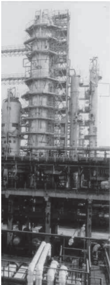
Установка ЭЛОУ-АВТ, 1995 год
