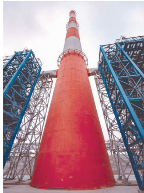
Дымовая труба установки изомеризации
