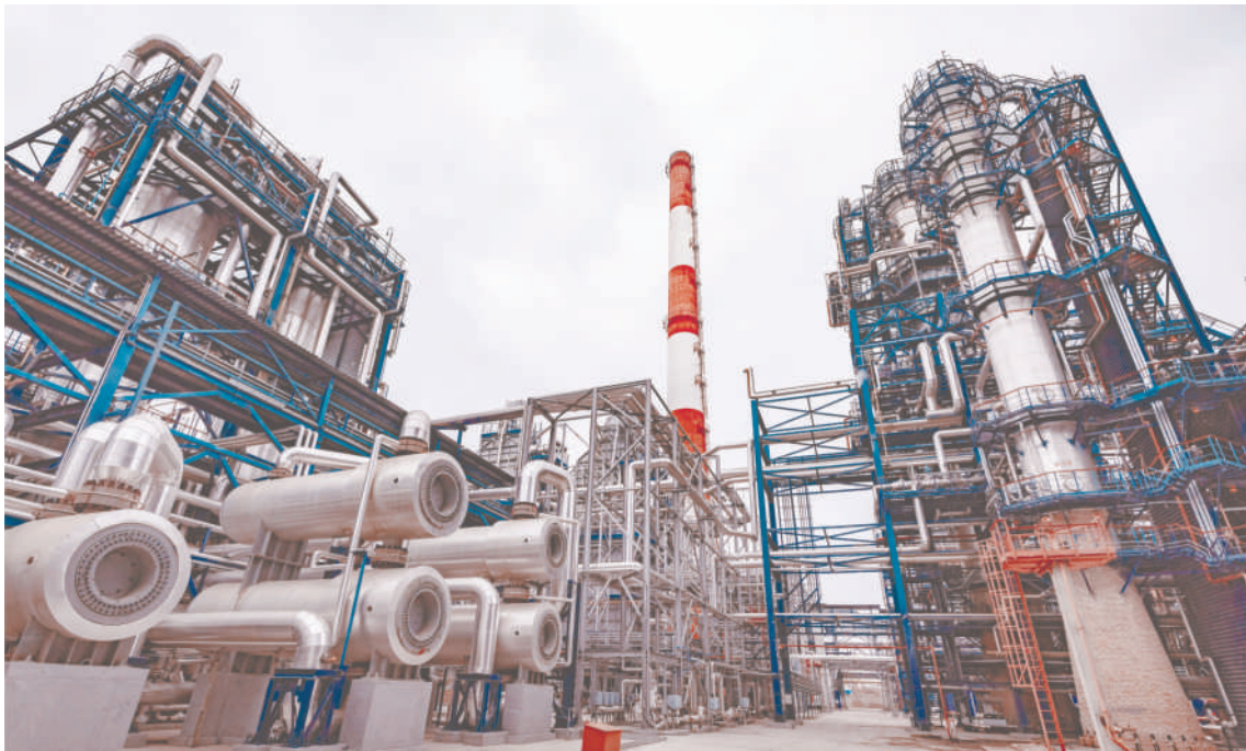
Установка гидрокрекинга ПАО «Орскнефтеоргсинтез»
