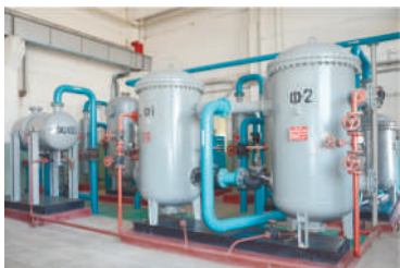
Машинный зал воздушной компрессорной. Блоки осушки №1 и №2 воздуха КИПиА
