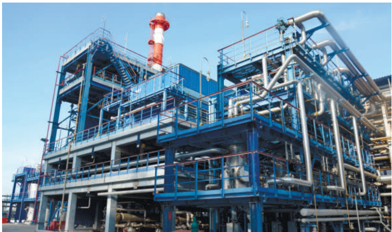
Установка производства водорода
