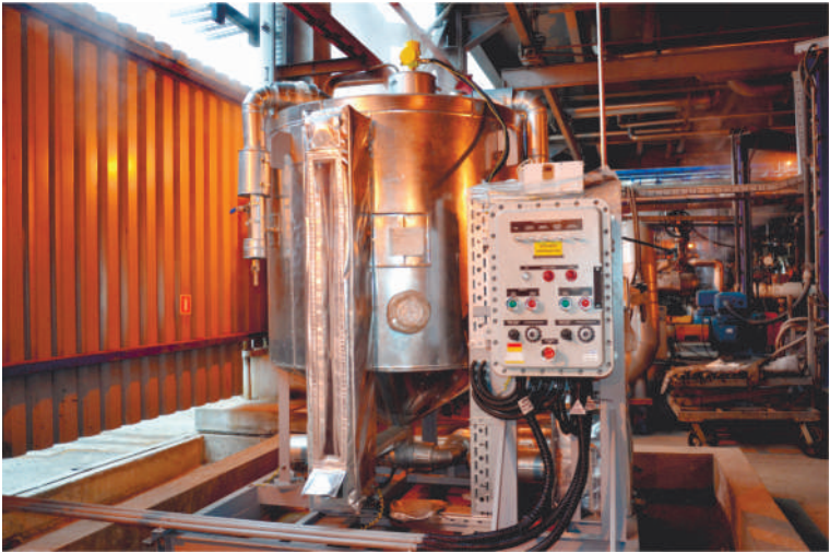
Дозировочные станции на установке висбрекинга смонтированы в холодной насосной
