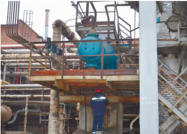
Теплообменник Т-14 необходим для подогрева колонны К-6
