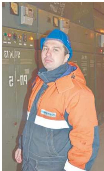
Электромонтер по ремонту электрооборудования Е. Титов обслуживает трансформаторную подстанцию
