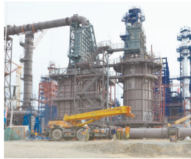
Трубчатые печи П-01 и П-02
