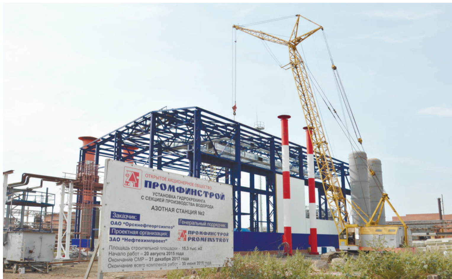
Азотная станция №2 – уникальная трехблочная мультимодульная система
