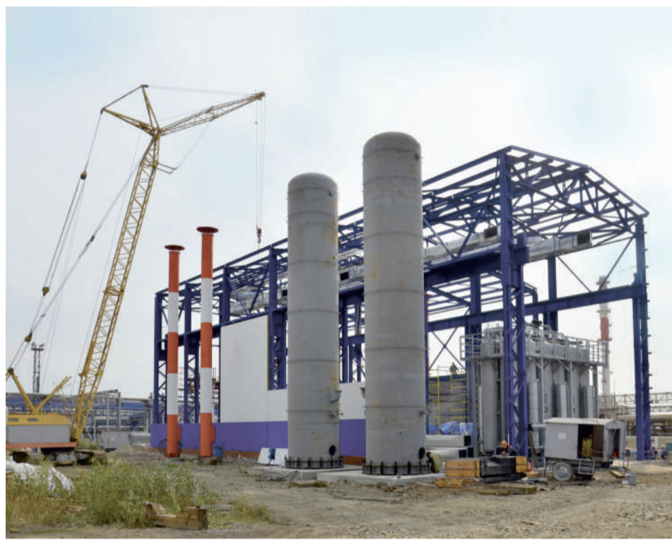
Оборудование для новой азотной станции поставлялось с разных уголков мира
