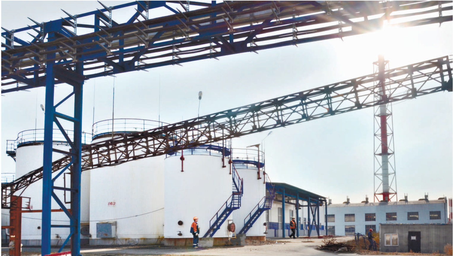
Вторая линия установки химводоподготовки Орского НПЗ будет обеспечивать очищенной водой Комплекс гидрокрекинга
