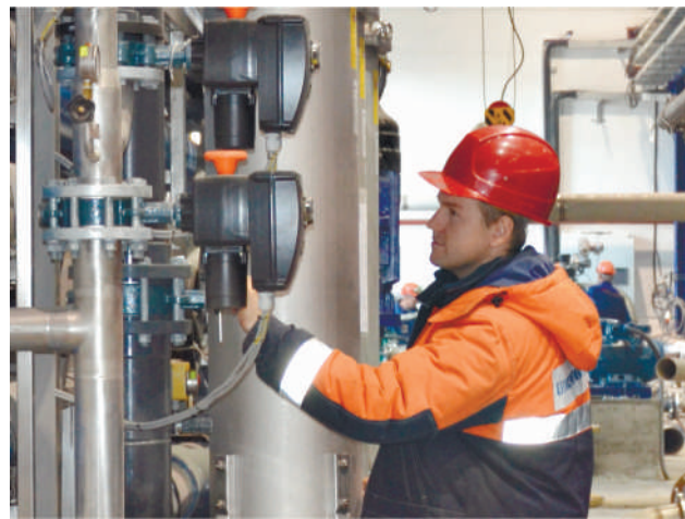
На 2-ой линии ХВП смонтирована обратноосмотическая система
