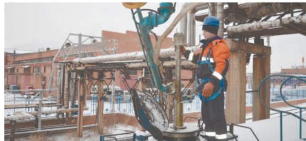
Товарный оператор Е.С.Егоров на новой эстакаде налива
