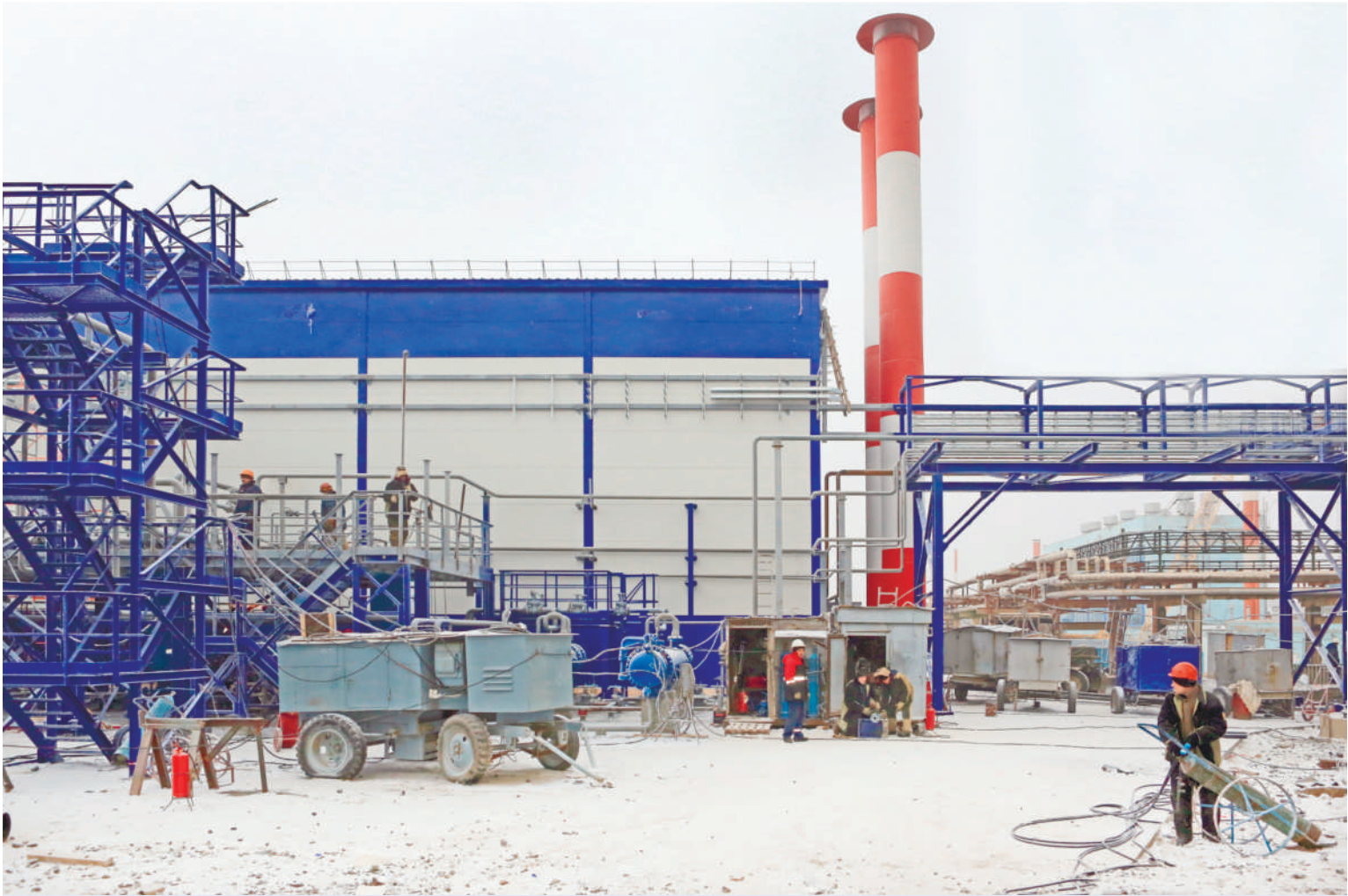
Блок компримирования ВСГ
