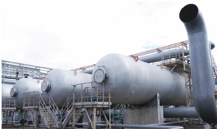
Водоблок будет обеспечивать оборотной водой все объекты Комплекса замедленного коксования
