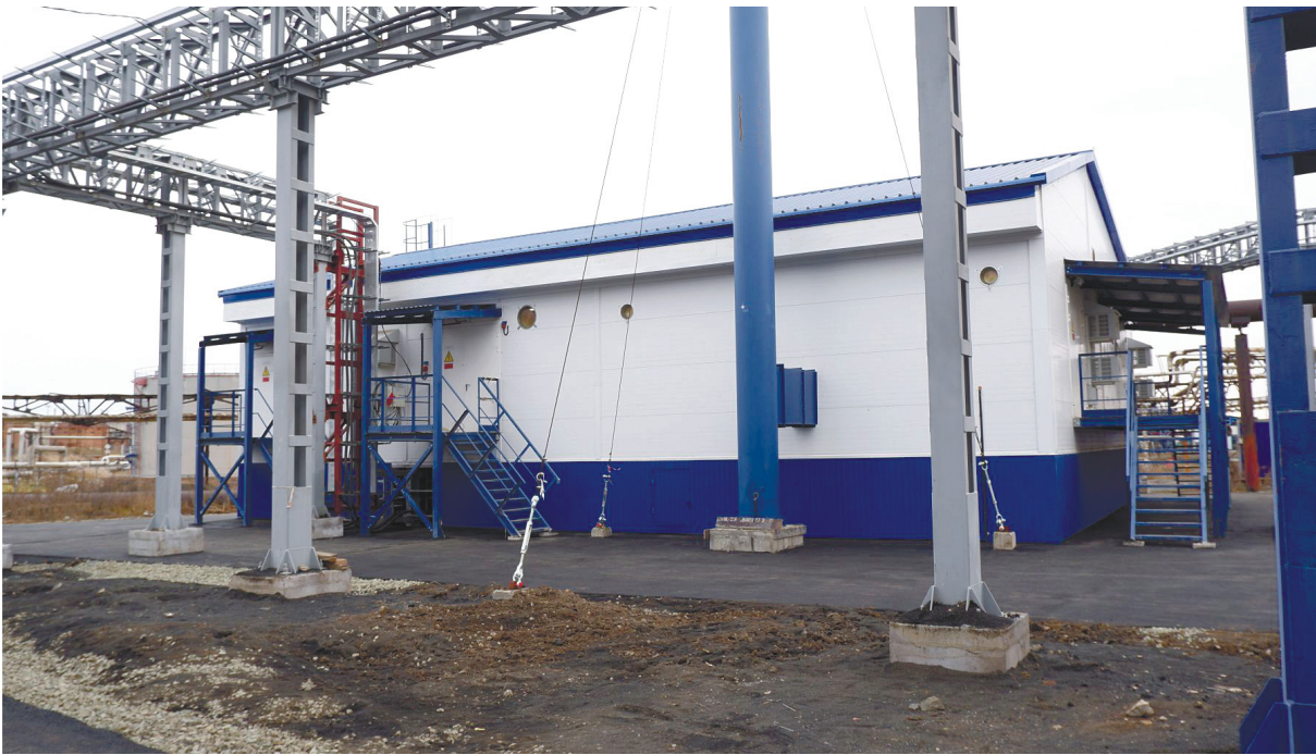
Центральная распределительная подстанция №2
