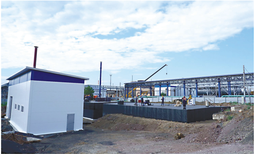
Резервуары питьевой воды с насосной
