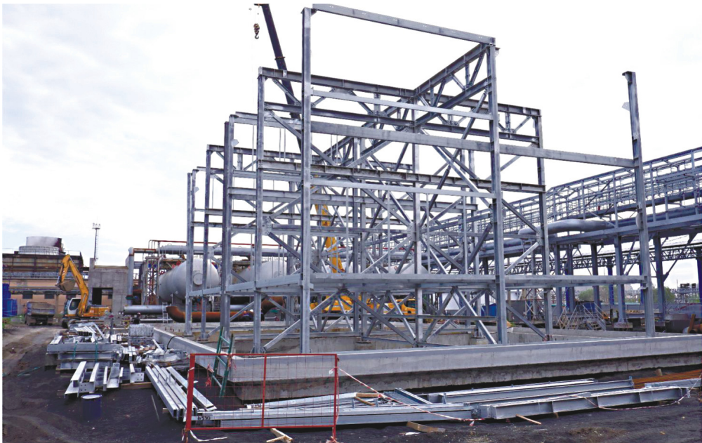
Водоблок Комплекса замедленного коксования
