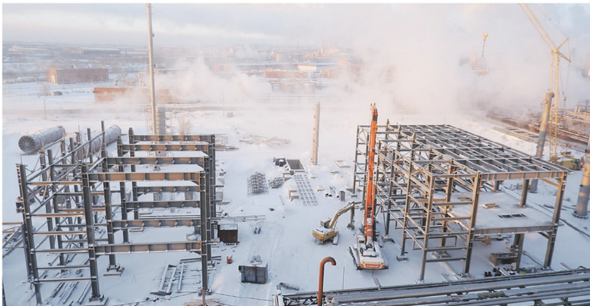
Установка замедленного коксования
