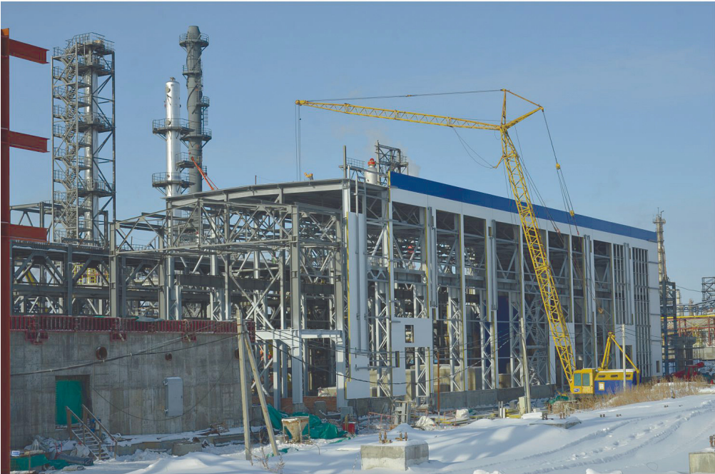
Установка гидроочистки дизельных и бензиновых фракций
