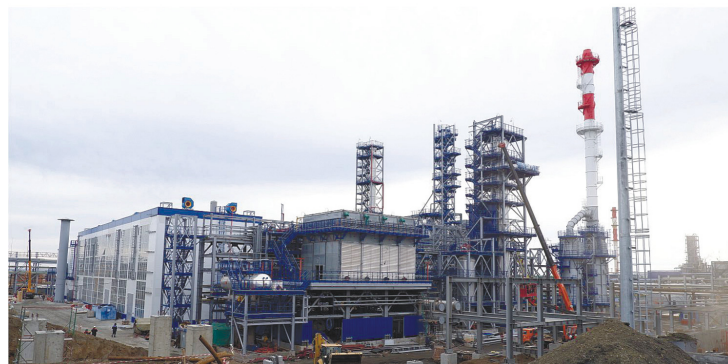
Установка гидроочистки бензиновых и дизельных фракций
