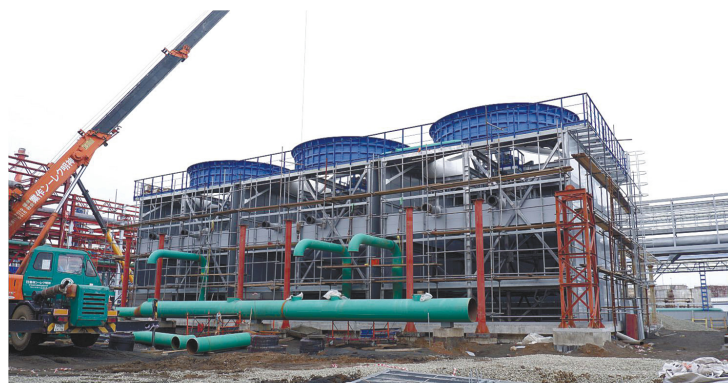
Водоблок Комплекса замедленного коксования
