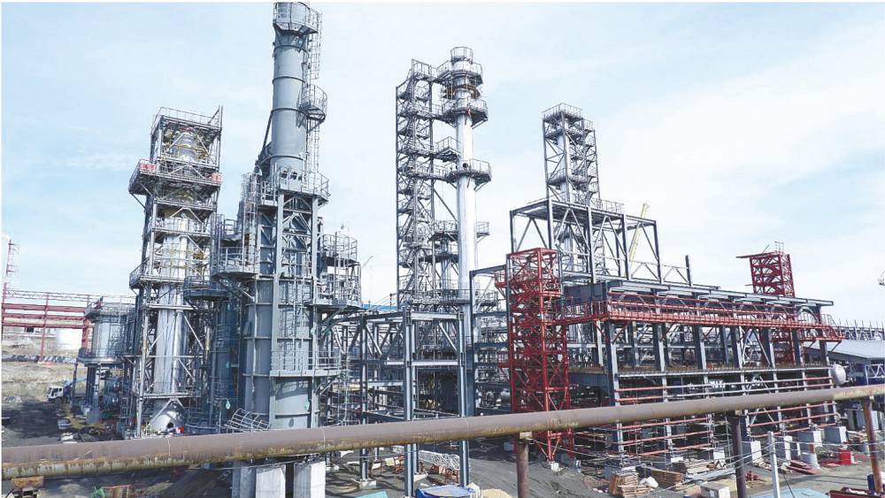
Установка гидроочистки бензиновых и дизельных фракций
