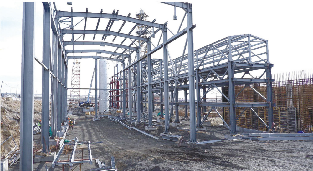
Установка отпарки кислых стоков и МДЭА
